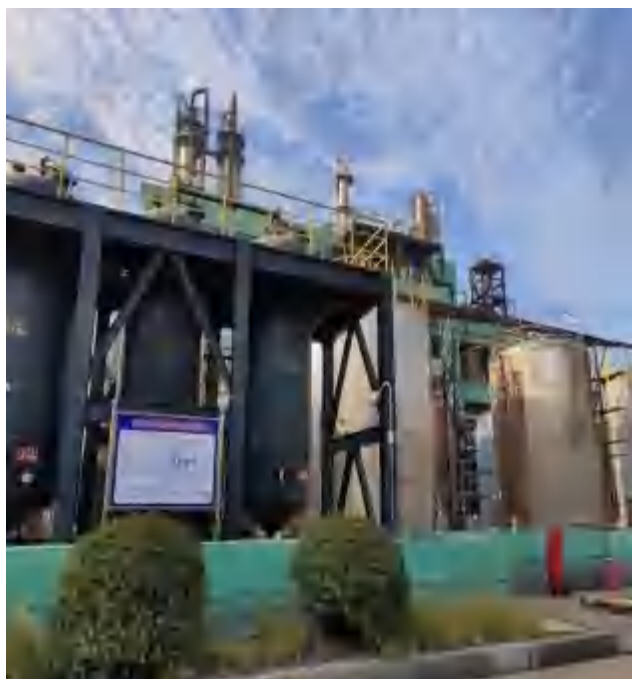
氯化苯中间罐区
