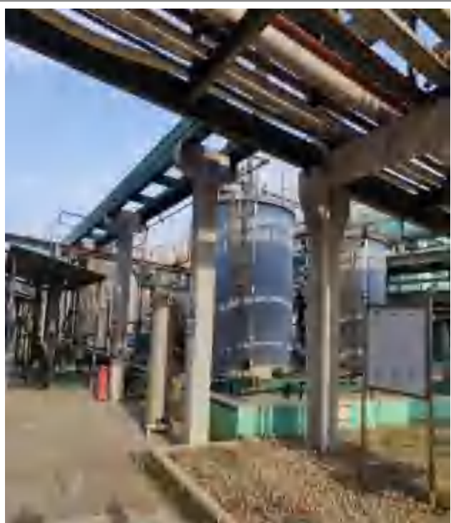
硝基氯苯罐区
